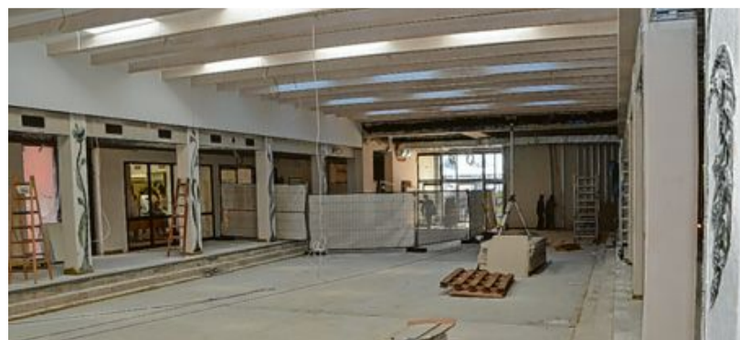
Auch die Aula des Gymnasiums wird generalüberholt. Rechts werden die Ganztagschüler betreut, links geht es in die Cafeteria. Auch für Abendveranstaltungen soll die Aula künftig zur Verfügung stehen.
